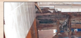
浴室のシロアリ被害
