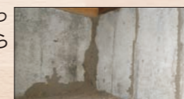
ベタ基礎の床下で発見されたシロアリの蟻道
